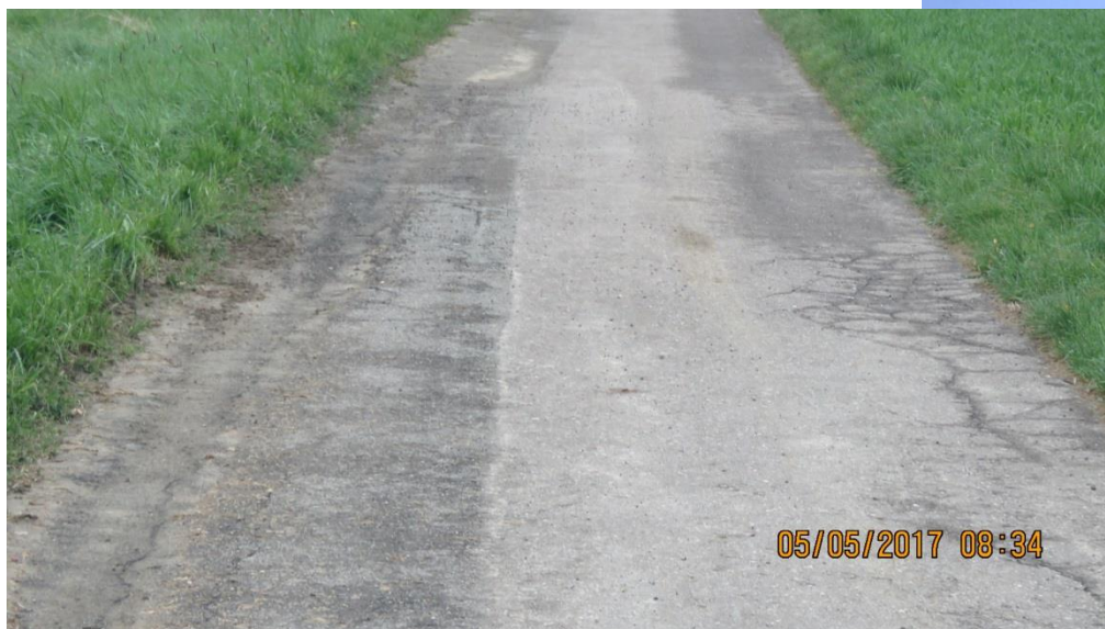
Schäden am Belag
